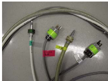
図3 人工呼吸器本体電源、加温加湿器電源、酸素管理、圧縮空気配管を色別ラベリング
